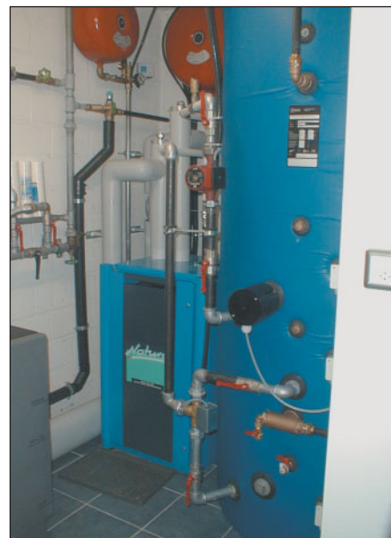
Turbo-Wärmepumpe Sole/Wasser mit maximal 65 °C Vorlauf ersetzt Ölkessel.
