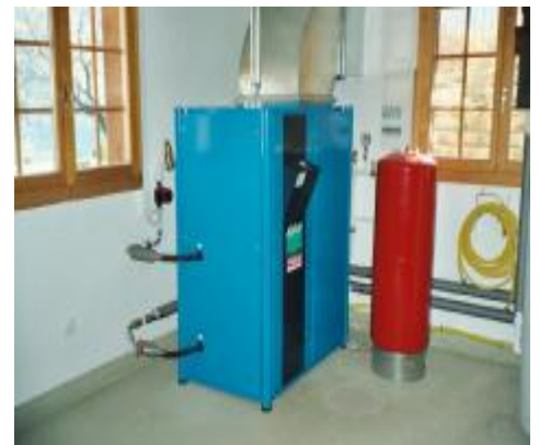
Pompe à chaleur Turbo air/eau avec température de départ maximale de 65\text{ }^{\circ}\text{C} en remplacement le chauffage électrique direct.
