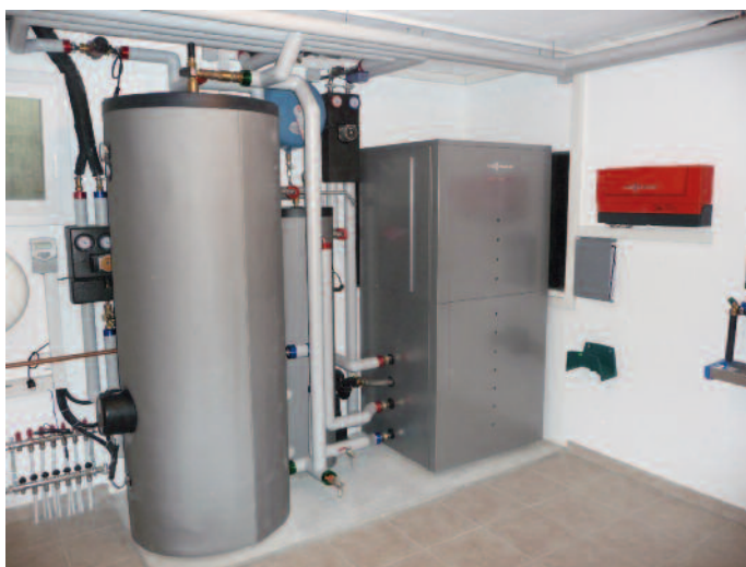
Bild 7: Technikraum mit e-Wärmepumpe Luft/Wasser: für Raumheizung und Warmwasser, kombiniert mit Solarkollektor. Kompakte Eckaufstellung.
