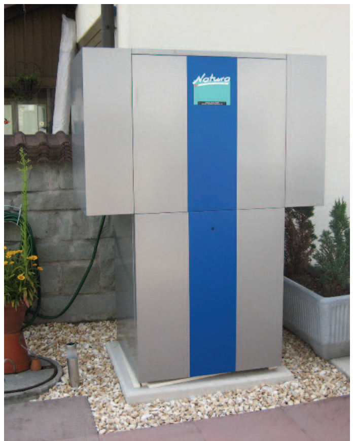
Bild 8: Aussenaufgestellte e-Wärmepumpe Luft/Wasser mit Leistungsmodulation von 3-9 kW
